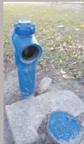
Ten hydrant w Księginicach Wielkich jest teraz bezużyteczny. Foto: ZUK Kondratowice
