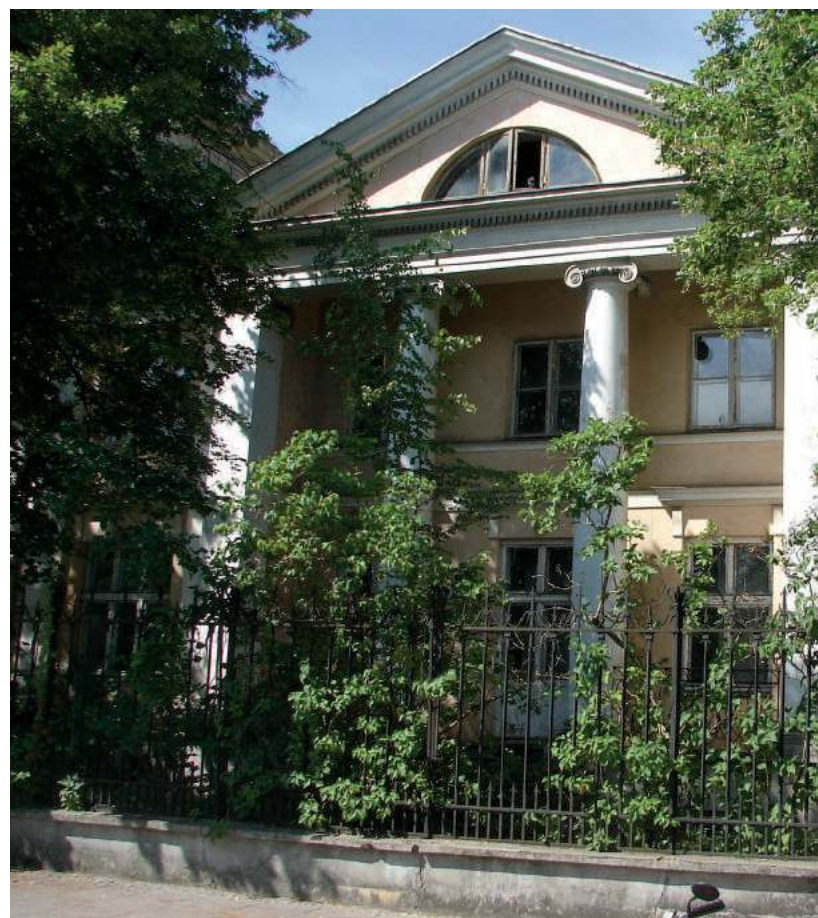
Opuszczony pałacyk Śleszyńskich i fragment rozpadających się tynków na jego elewacji | fot. Janusz Sujecki
