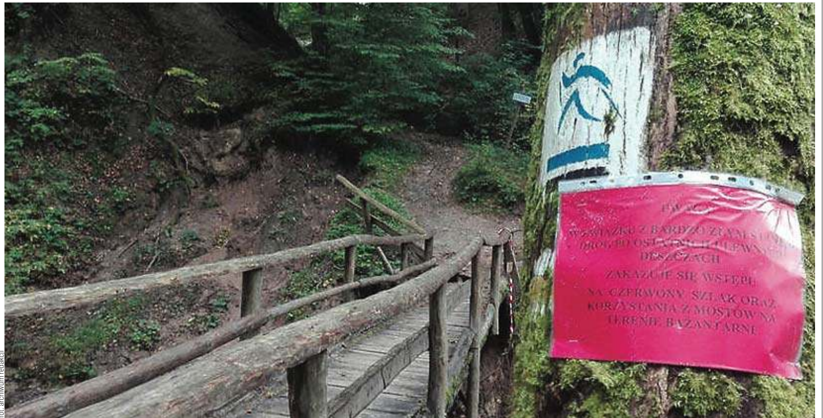
Mostek Elewów po powodzi w 2017 roku został wyłączony z użytkowania
