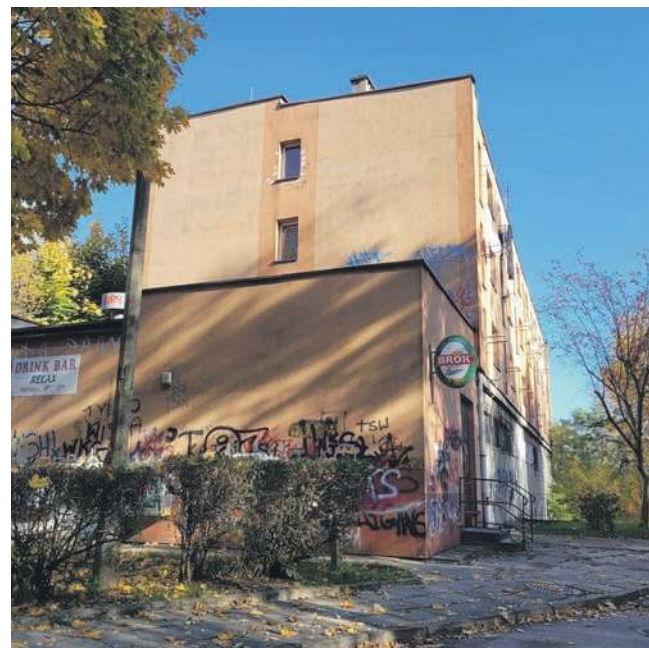
Dawny hotel robotniczy w Górze z powodu stanu technicznego skazany jest na niebyt. Gmina chce sprzedać tę nieruchomość
