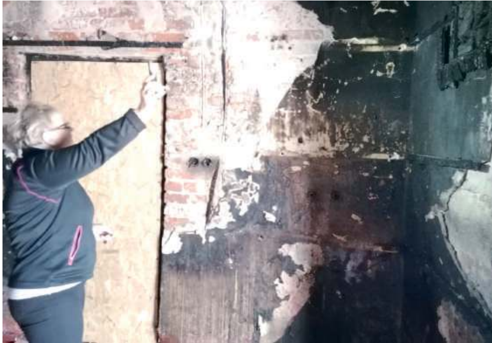
W sobotę odwiedziliśmy rodzinę Rosińskich. Pani Maria pokazała nam ogrom zniszczeń spowodowanych przez pożar. Na zdjęciu korytarz, w którym ogień pojawił się jako pierwszy. Dom nadaje się do kapitalnego remontu
