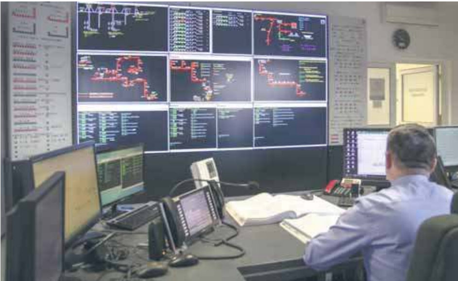
Nowy system pozwoli m.in. na szybsze przywracanie urządzeń do pracy w przypadku awarii
