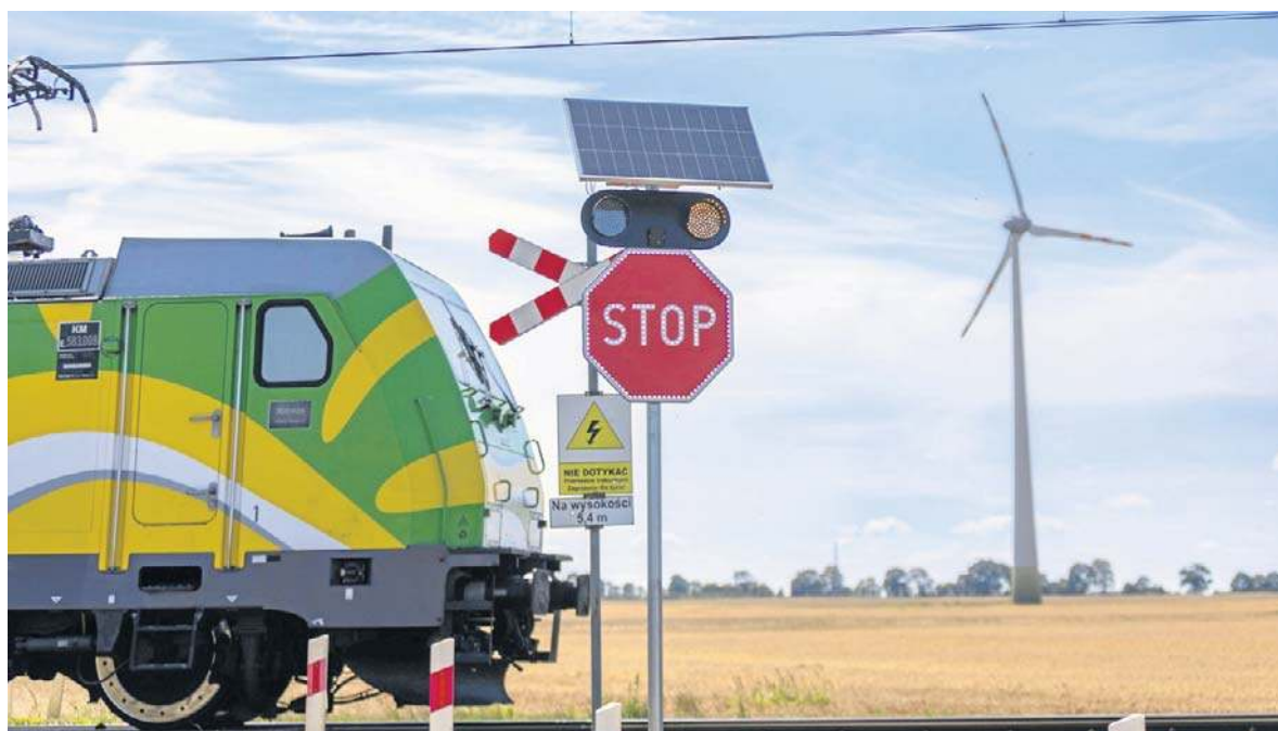
Aktywne znaki STOP mają zwiększyć bezpieczeństwo na przejazdach kolejowo-drogowych
