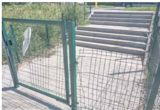
Bramka wejściowa jest doszczętnie zniszczona
