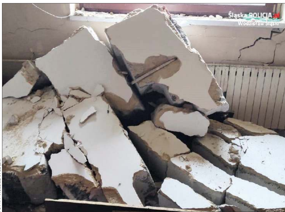
Wewnątrz budynku przewróciła się jedna ze ścian
