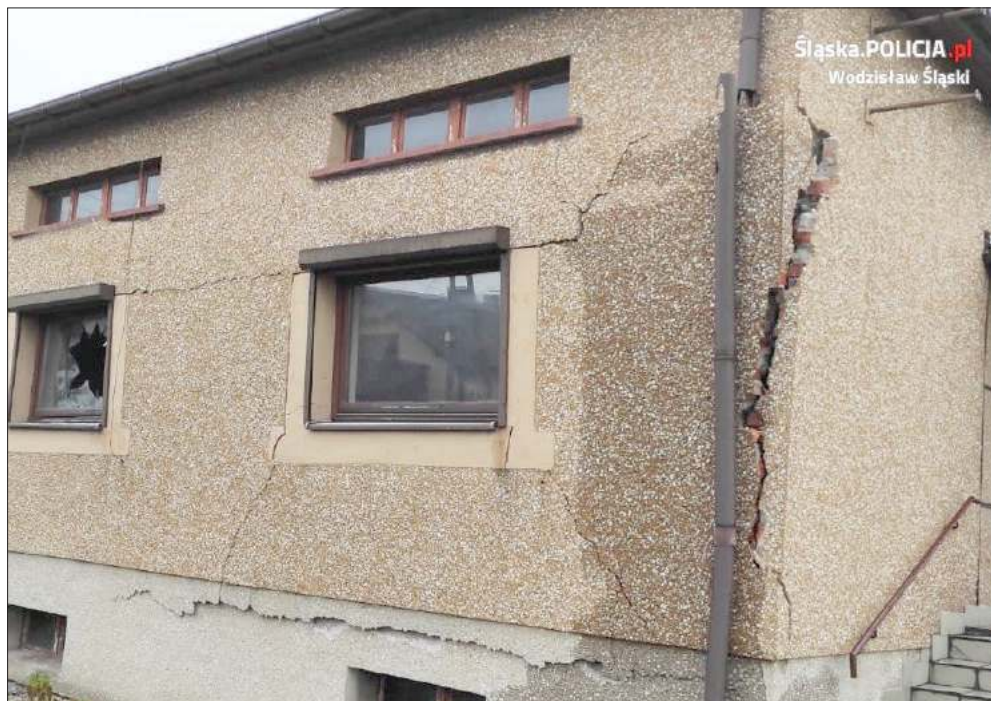
Dom został wyłączony z użytkowania, konstrukcja została naruszona
