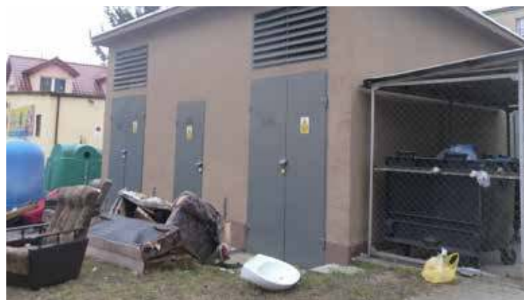
Miejsce to często wygląda właśnie tak. Brak jest swobodnego dojścia do drzwi prowadzących do urządzeń transformatora
