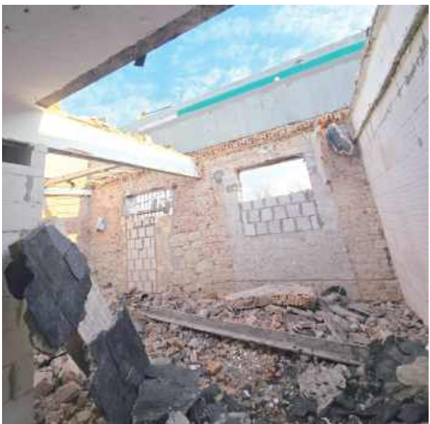
Mężczyzna pracował przy przebudowie obiektu sportowego dla miejscowego klubu piłki nożnej. W pewnym momencie spadł na niego walący się strop
