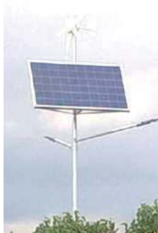
W Świerżach latarnie stanęły na uczęszczanych skrzyżowaniach
