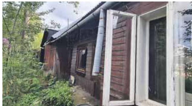
Tak wygląda parterowy pustostan, w którym mieszkają bezdomni.
