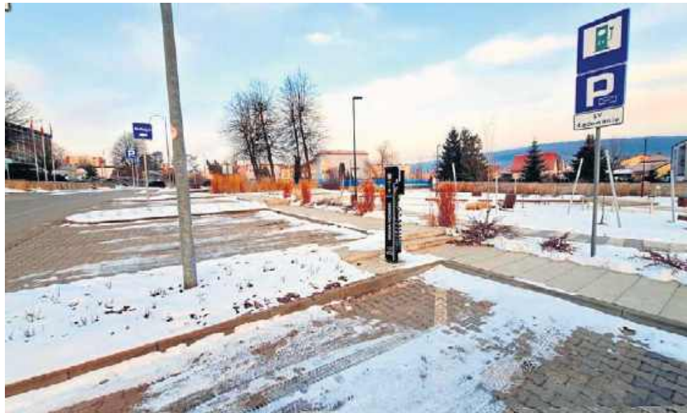
Stację ładowania pojazdów elektrycznych uruchomiono przy urzędzie gminy w Nowinach
