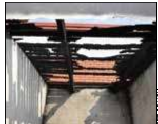
W wyniku pożaru częściowe spaleni uległo poszycie dachu wraz z jego drewnianą konstrukcją
