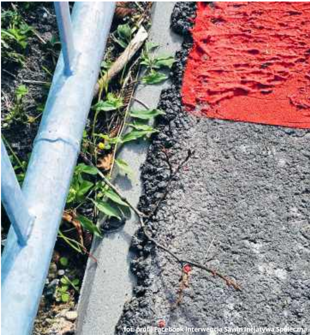
Niektóre elementy zostały wykonane niedokładnie
