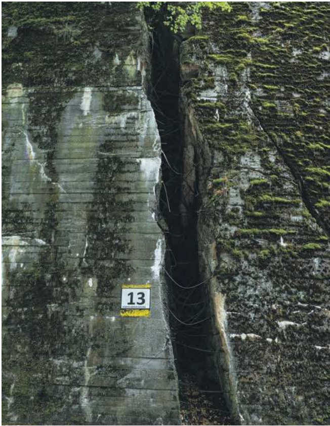
Uszkodzenia ścian bunkrów powstałych w wyniku wysadzenia ich przez wycofujące się siły niemieckie
