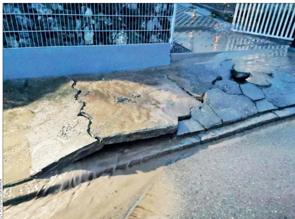
Nadmiar wód opadowych uszkodził drogi i chodniki
