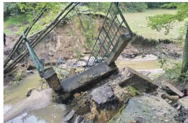
Tyle zostało z mostu w parku Repeckim po przejściu nawałnicy
