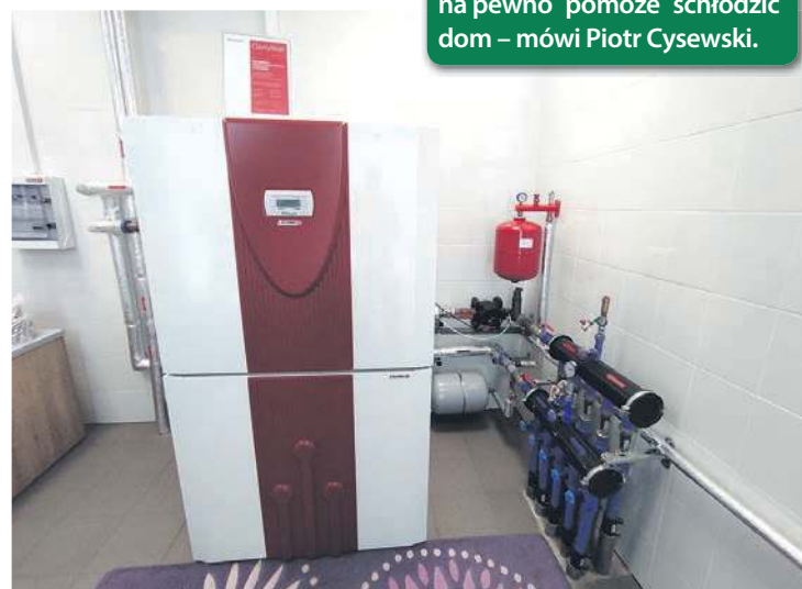
Tak wygląda pompa ciepła przyłączona do instalacji gruntowej.
