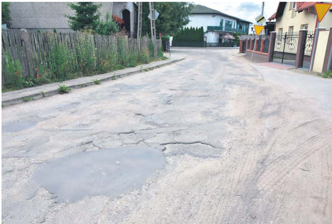
Nawierzchnia ul. Wiatrakowej w Bysławiu rzeczywiście pozostawia wiele do życzenia...
