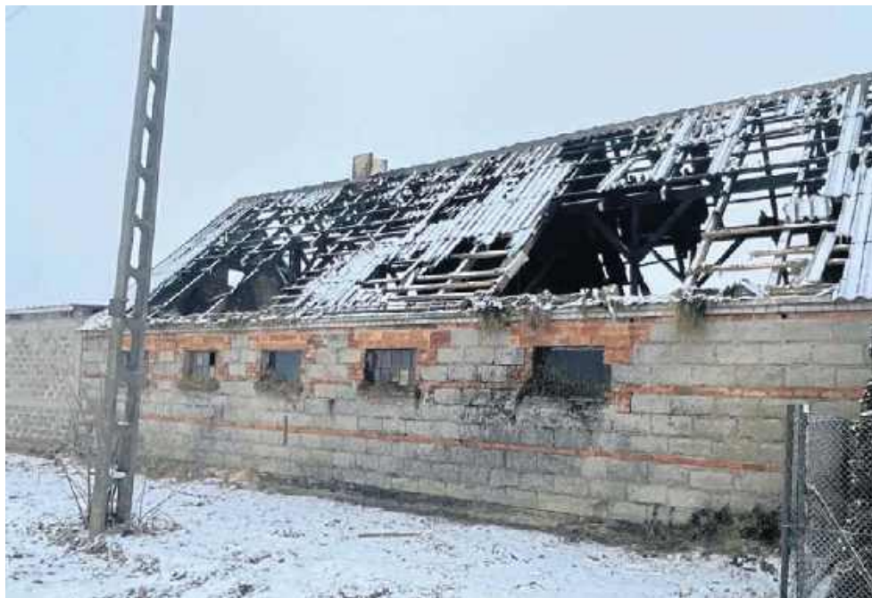
Dach obory spłonął w pożarze.
