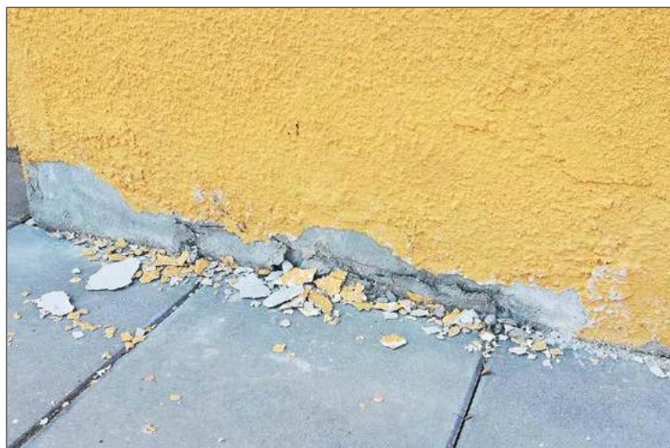
Świeżo wyremontowana hala zaczyna się sypać.
