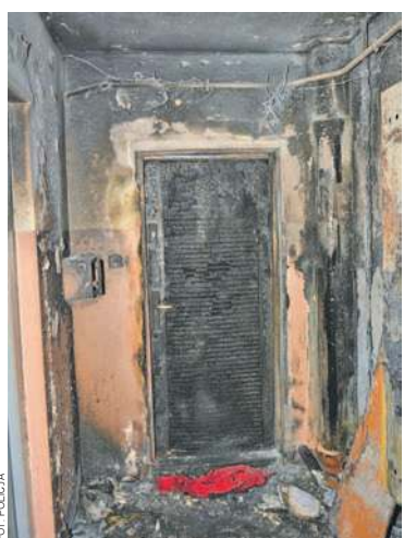
Mężczyzna podpalał klatki schodowe w blokach przy ul. Wyszyńskiego w Tarnobrzegu
