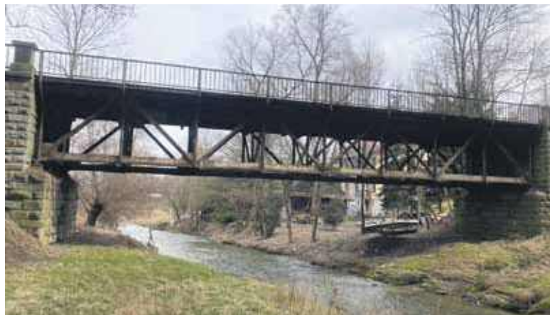
Stary most jest w fatalnym stanie technicznym.
