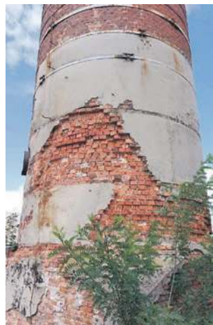
Mieszkańców Trzebini niepokoi stan komina przy ul. Ochronkowej
