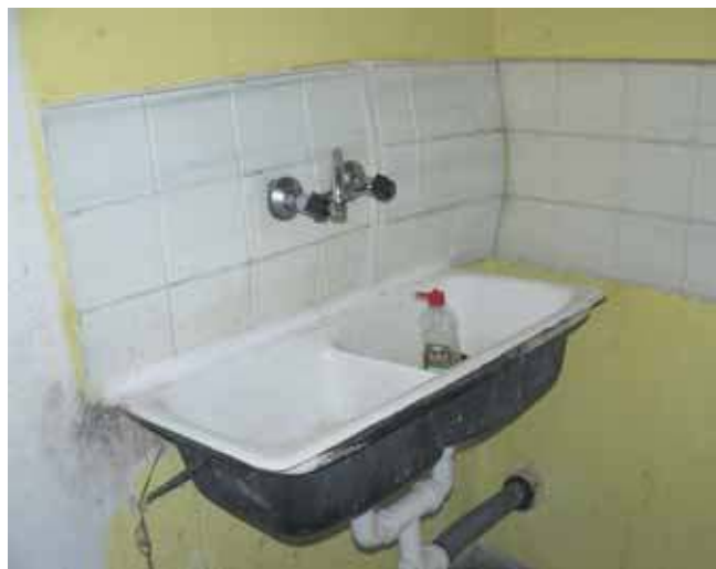
Kuchnia w jednym z zaproponowanych tarnogórzaninowi mieszkań. MTBS zobowiązało się do wymiany zlewozmywaka, ale tu potrzeba większego remontu. Lokator mówi, że przy swoim stanie zdrowia nie jest w stanie go wykonać
