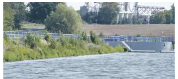
Wrastające w tamę korzenie krzaków mogą doprowadzić do jej rozszczelnienia
