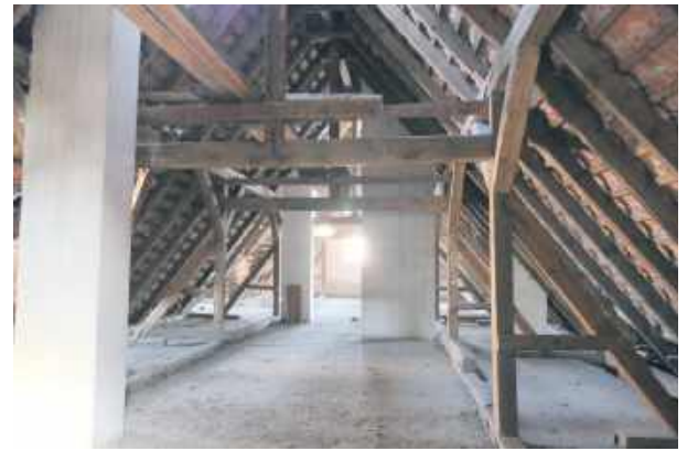
Obecnie najpilniejszą potrzebą remontową jest zabezpieczenie dachu budynku
