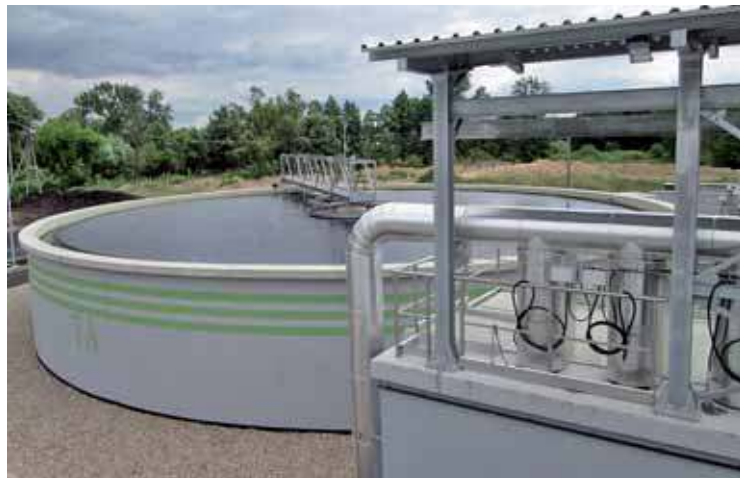
Z tego pojemnika oczyszczone ścieki trafiają bezpośrednio do Seracza
