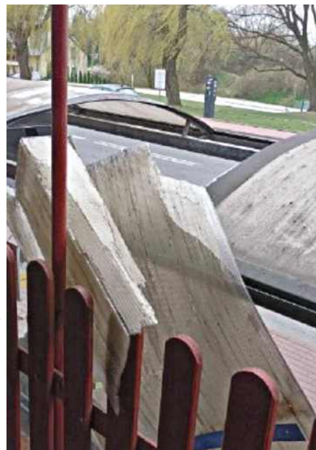
Mężczyzna wszedł na wiatę autobusową przy ulicy Traugutta. Konstrukcja nie wytrzymała obciążenia, w wyniku czego doszło do zarwania dachu
