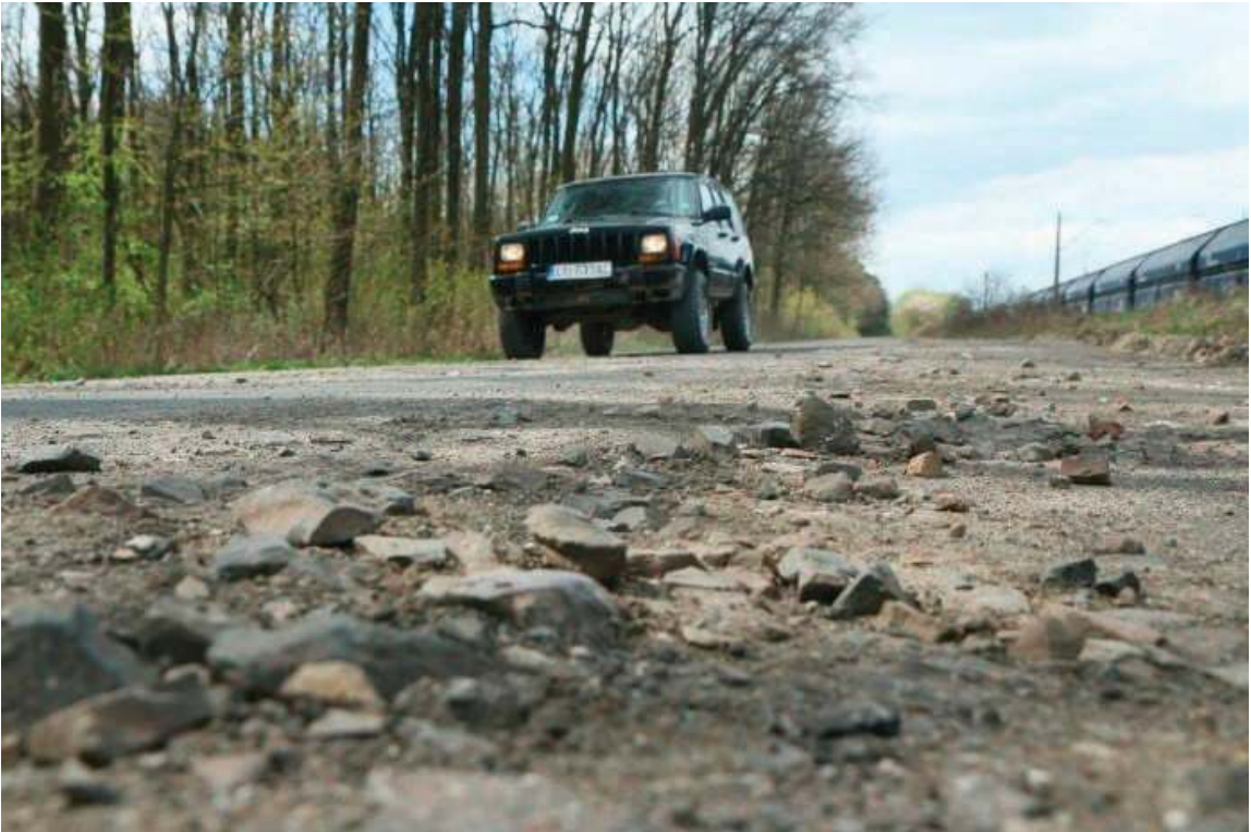
Na remont należącego wciąż do Kolei odcinka ulicy Dworcowej trzeba będzie jeszcze poczekać
