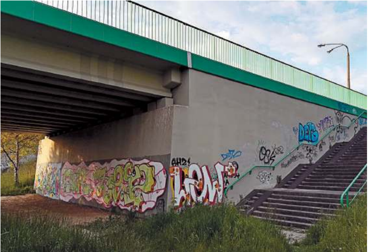
Oszpeczony wiadukt na al. Smorawińskiego
