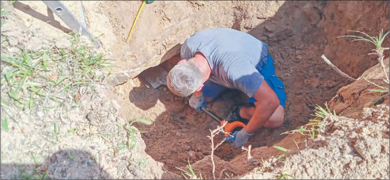
W 2015 roku budynek szkoły im. Kajetana hr. Kickiego w Sobieszynie przeszedł pierwszy etap renowacji. Po prawie 10 latach okazało się, że brakuje podbicia fundamentów zewnętrznych i wewnętrznych budynku. Potwierdziła to wizja lokalna, podczas której wykonano odkrywkę fundamentów. Sprawą zajęła się prokuratura
