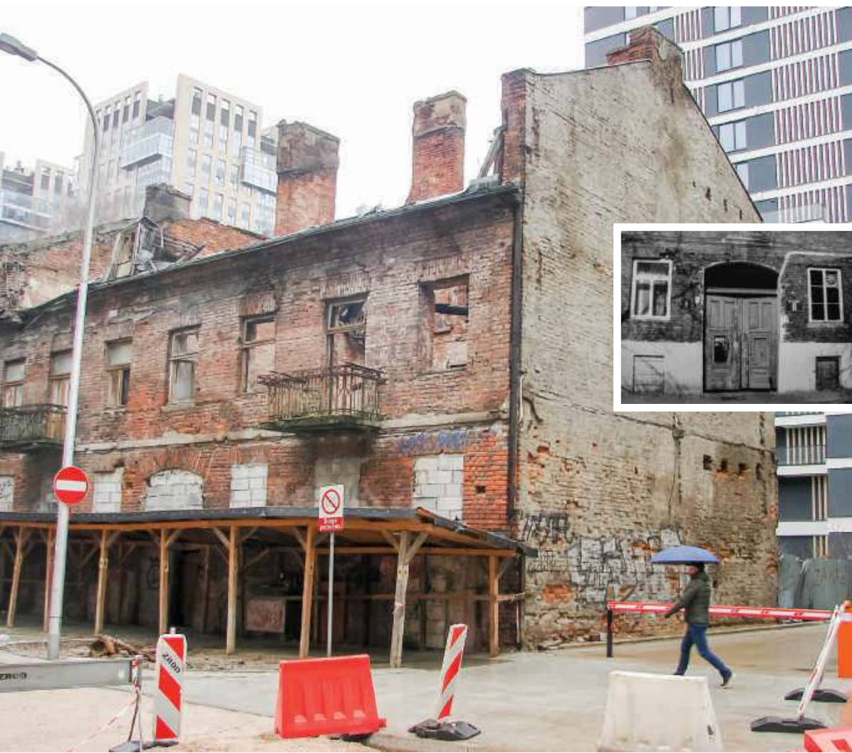
Obecny stan murów kamienicy przy ul. Łuckiej 8 i wrota jej przejazdu bramnego na zdjęciu wykonanym przez autora artykułu w listopadzie 1987 r.
