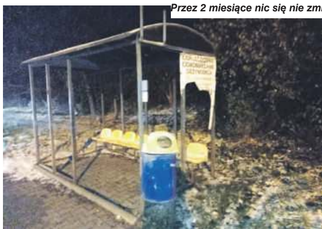
Zdewastowany przystanek w Nowym Dworze - powybijane szyby. Stan sprzed 23 listopada 2023 r.
