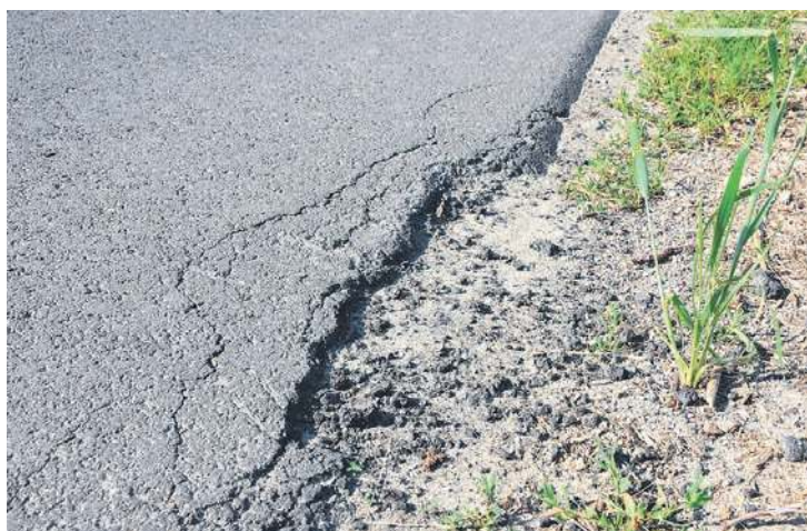
Połamane pobocza ulicy Piłskiej. Tak jest w wielu miejscach na niedawno położonym asfalcie.
