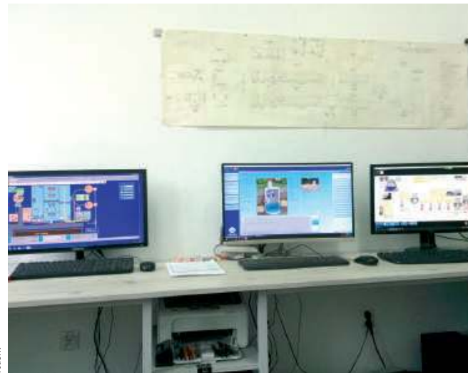
Centrum sterowania ujęciami wody – element infrastruktury zbudowany w ramach zadania związanego z monitoringiem ujęć
