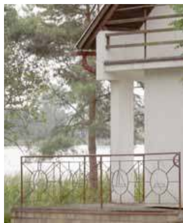
Domki na plaży od wielu miesięcy pozostają bez gospodarza - gmina zupełnie nie radzi sobie z ich utrzymaniem, a ośrodek popada w ruinę
