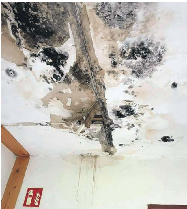
Tak wygląda sufit kuchni w czekającej na remont i dopuszczenie do użytkowania części świetlicy
