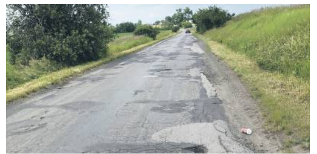
Odcinek Białobrzezie-Pożarzyce przed remontem
