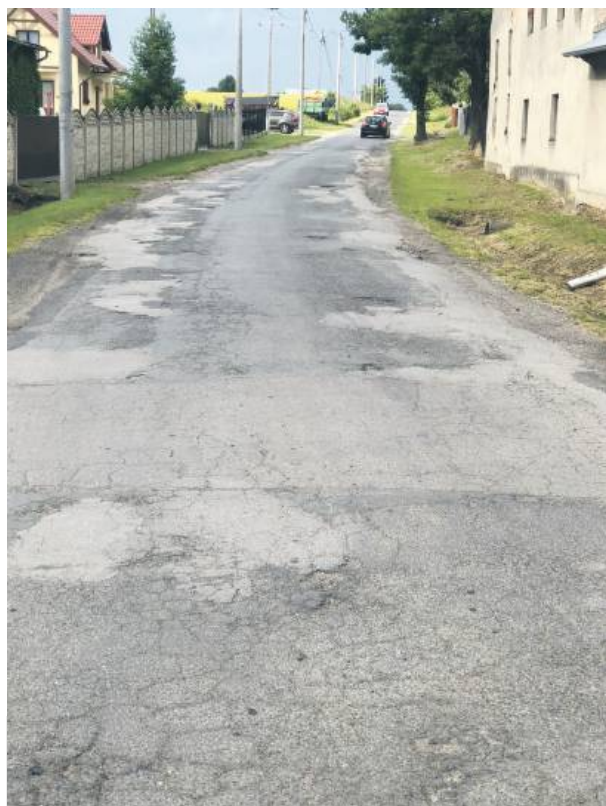
Droga w Karczynie przed remontem
