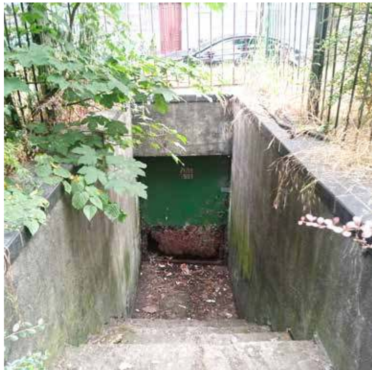
Stan wejścia do schronu pozostawia wiele do życzenia
