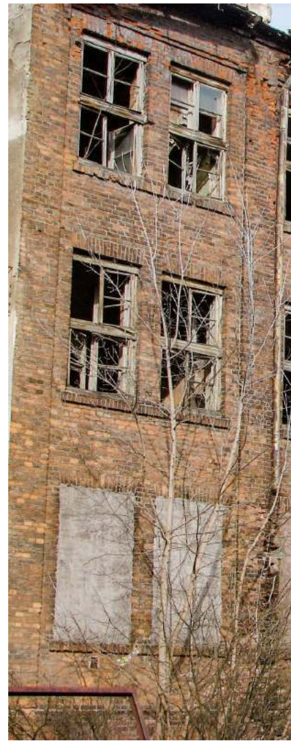
Zdewastowany budynek pofabryczny od strony ul. Ró
