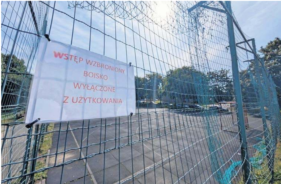
Dziury w ogrodzeniu, wystające druty i nierówności w nawierzchni - tak wygląda aktualnie boisko przy ulicy Kosynierów Gdyńskich w Słupsku
