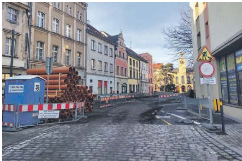
Dopiero po zakończeniu remontu ul. Wrocławskiej będzie znany sposób parkowania
