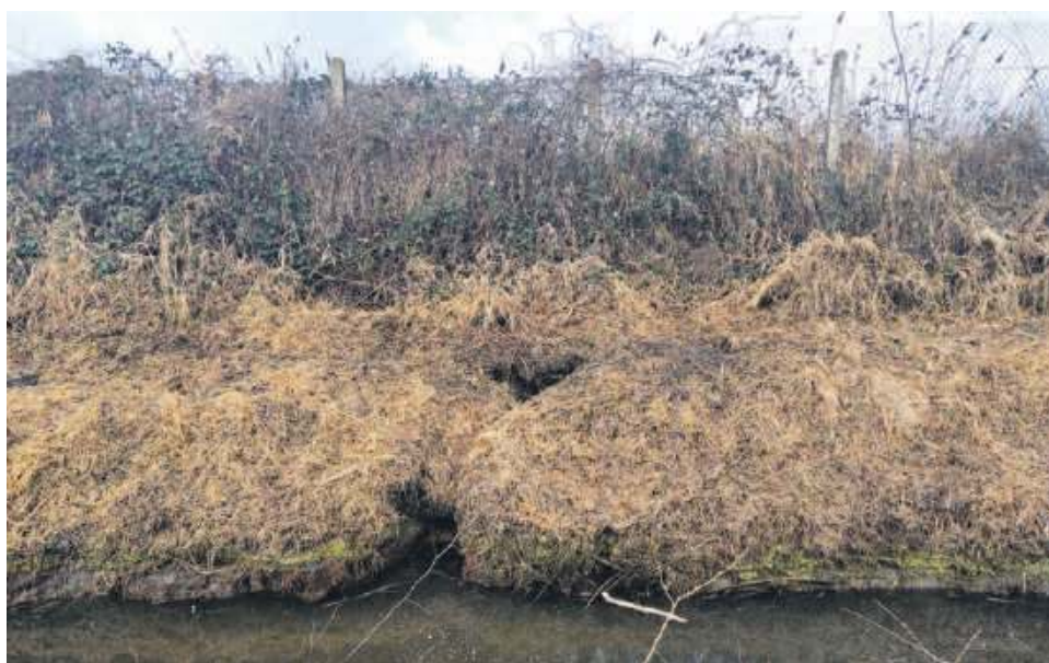
W grobli dzielącej staw hodowlany od osiedla bobry wykopały jamy. Mieszkańcy się boją, że po napełnieniu stawu wodą grobla nie wytrzyma i zaleje pobliskie domy
