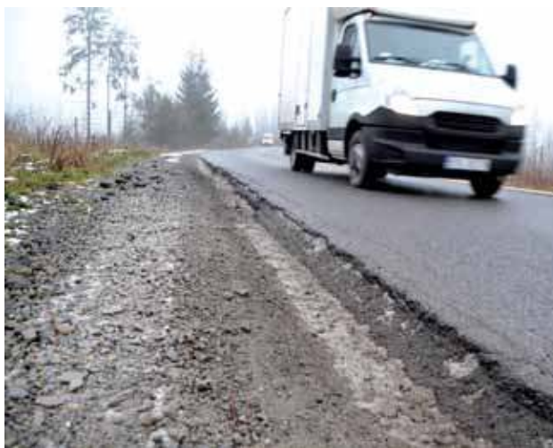
W wielu miejscach pobocza wymywa woda.
