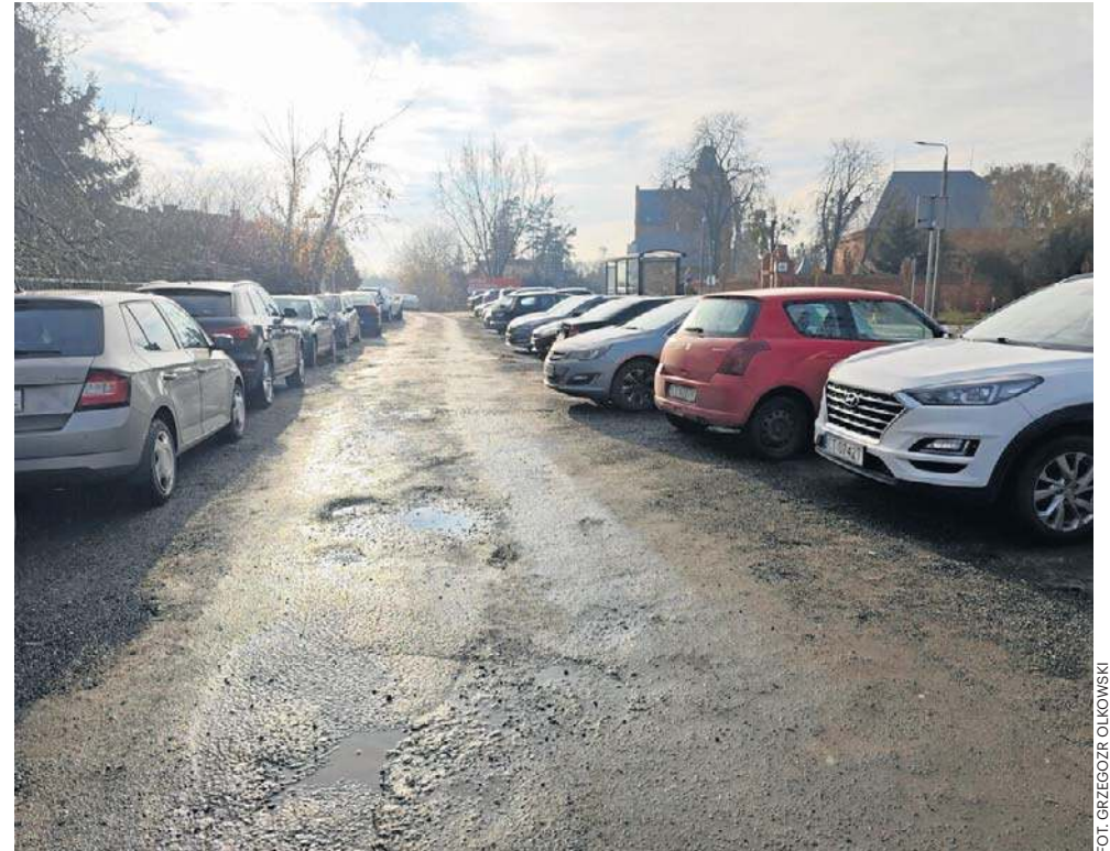
„Dziki” parking na ulicy Kaszubskiej w Toruniu. Od lat wymaga ona przebudowy
