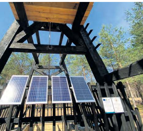
Widok jak na wieżę wydobywczą sprzed wieku... Te panele umożliwiają całkowite oświetlenie wieży. Były też ważnym elementem projektu, którego udało się uzyskać dofinansowanie.
