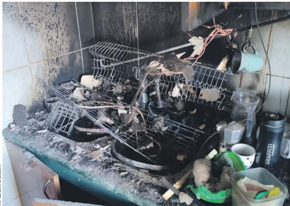
(E) Spalona kuchnia w domu na osiedlu Południe w Chrzanowie
