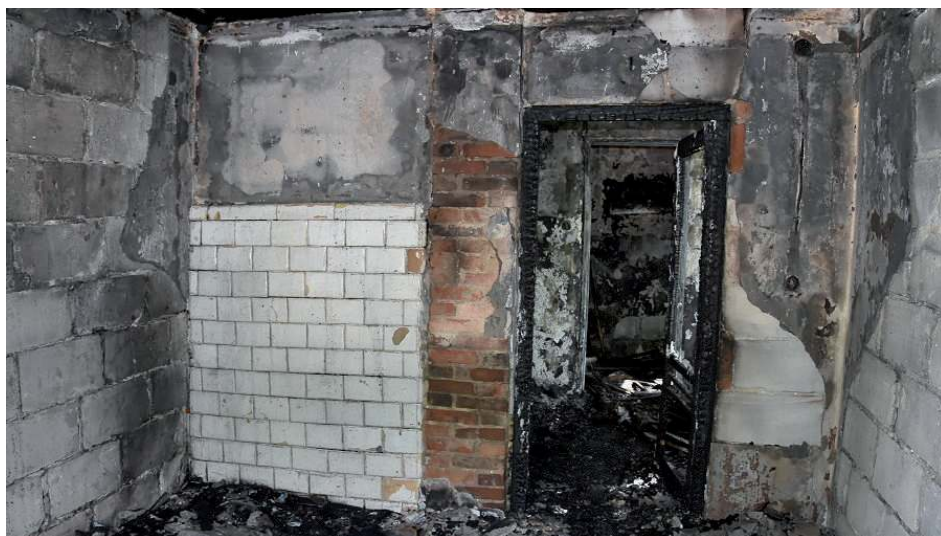
Skutki podpalenia niezamieszkałego domu
