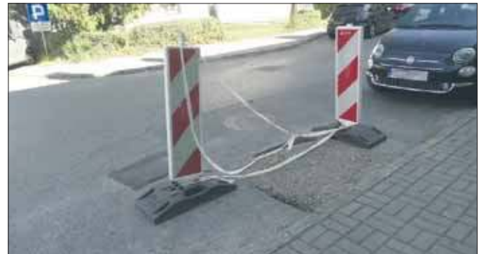
Dziura na ul. Gwarków
