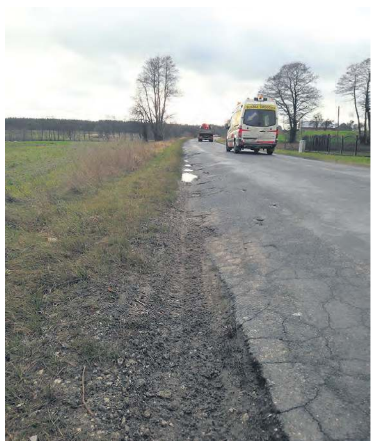
Ubytek w jezdni został naprawiony 1,5 miesiąca po zdarzeniu. Fot. Wojciech Babiński
