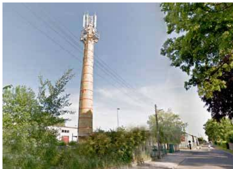
Anteny na kominie przy ul. Cmentarnej
